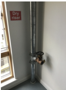
Dry riser outlets
