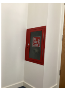
Dry riser outlet
