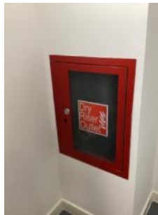
Dry riser outlet
