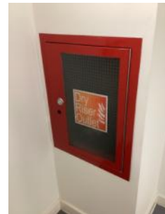
Dry riser outlet
