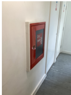
Dry riser outlet
