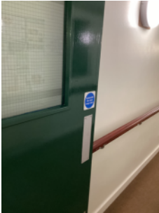
Automatic fire door signage
