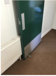
Wedged fire door
