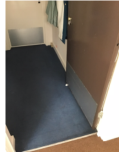
Wedged fire door
