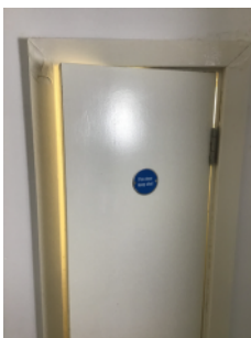
Incorrect door signs
