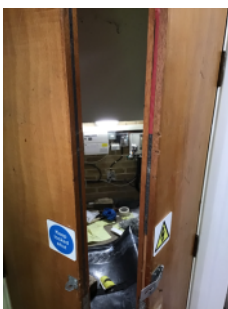
Fire door signage
