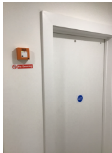
Smoke vent door
