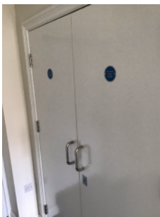
Fire door signage
