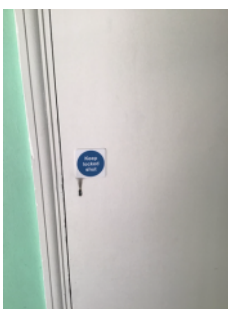
Fire door signage
