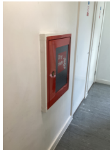
Dry riser outlet
